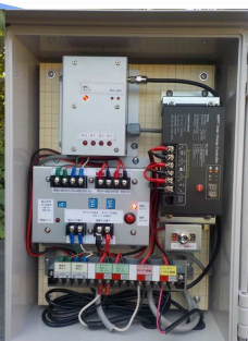
受信機保護ケース内部 結線状況
