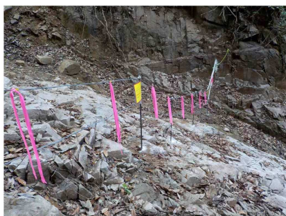
ワイヤーセンサー(TOV-SS)設置例 上段(0.7m)下段(0.3m)2段張り
