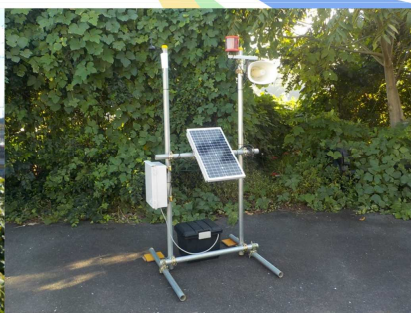
受信機・警報機・独立電源(ソーラー電源) 標準バッテリー50Ah・ソーラーパネル30W
